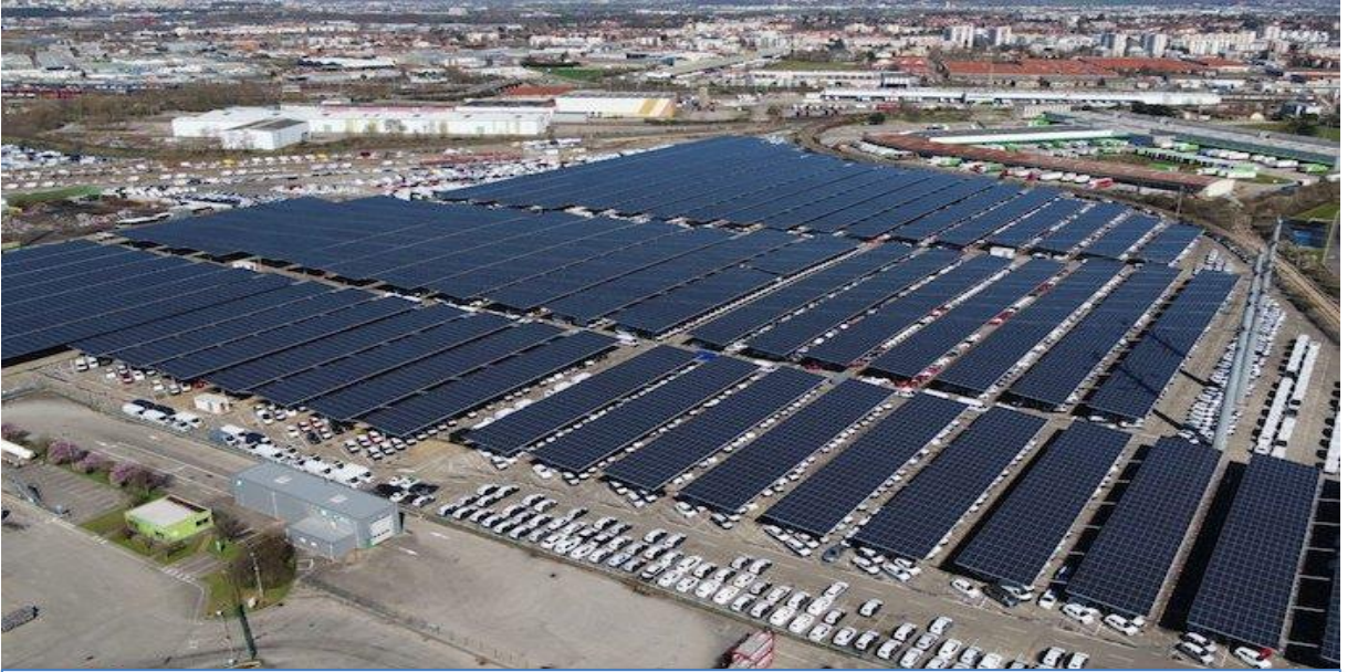
Fransa'da 16,3 MW'lık otopark güneş santrali açıldı
